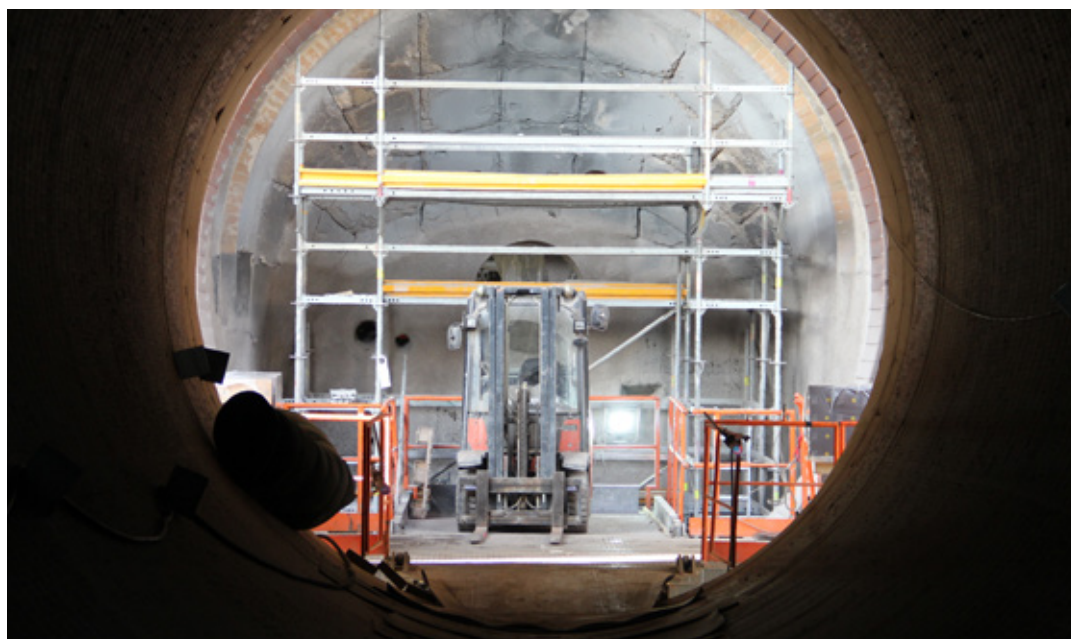
Teplota v rotační peci dosahuje až 1 600 °C. Než do ní můžeme bezpečně vstoupit, musí proto chladnout nejméně 24 až 36 hodin. Celý pecní systém se po odstávce rozzhává na pracovní teplotu za 50 až 60 hodin.
